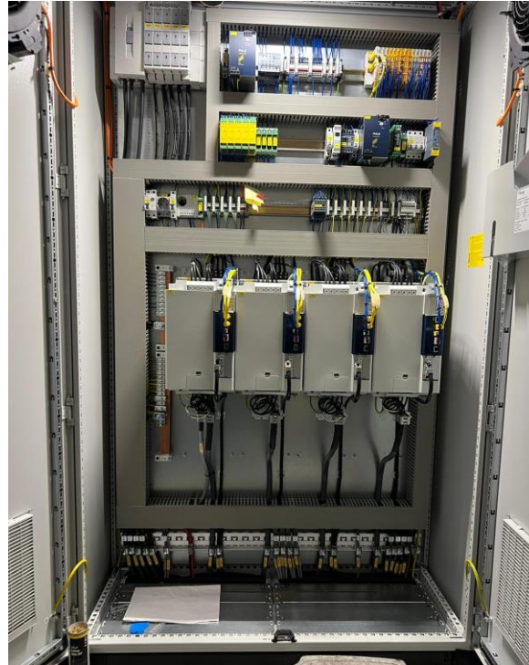
AZ & EL amplifiers cabinet
